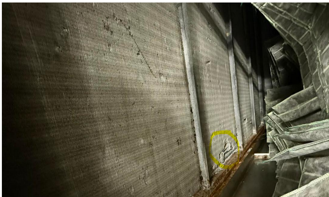
Figur 7 Foto inifrån aggregatet. Värmeåtervinningsbatteriets tilluftssida med porösa och delvis bortnötta flänsytor.
